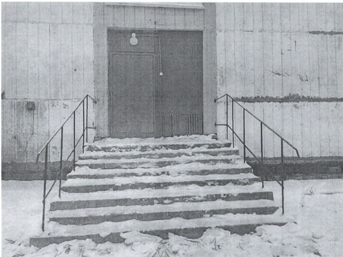
Фото №4. Перила на запасных выходах.
